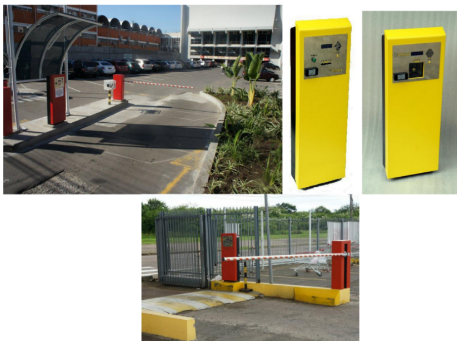
Figura 1. Totens e cancelas de estacionamento fornecidas por Passo Automação.
